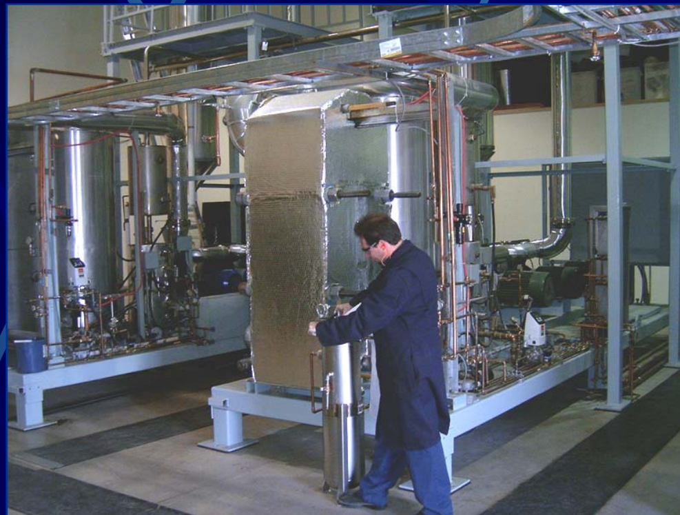
Сепараторная установка по регенерации гликоля в аэропорту г. Галифакс
